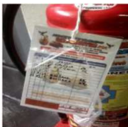
EXTINTOR SEDE ANTARES
